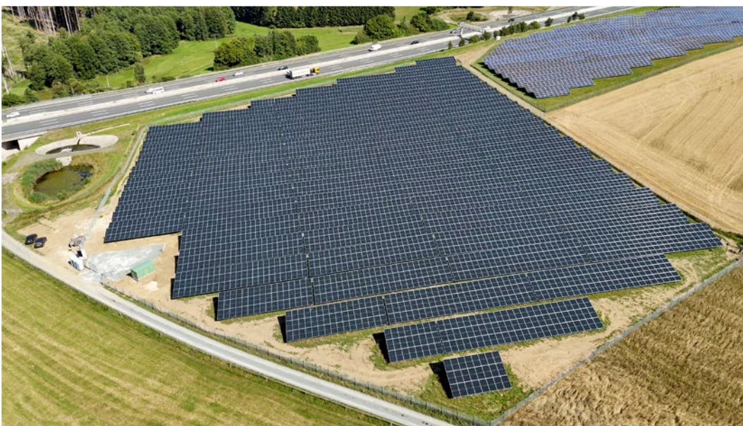
Beispiel einer privilegierten Fläche des Solarparks Witzleshofen, der direkt an der Autobahn A9 errichtet wurde.
