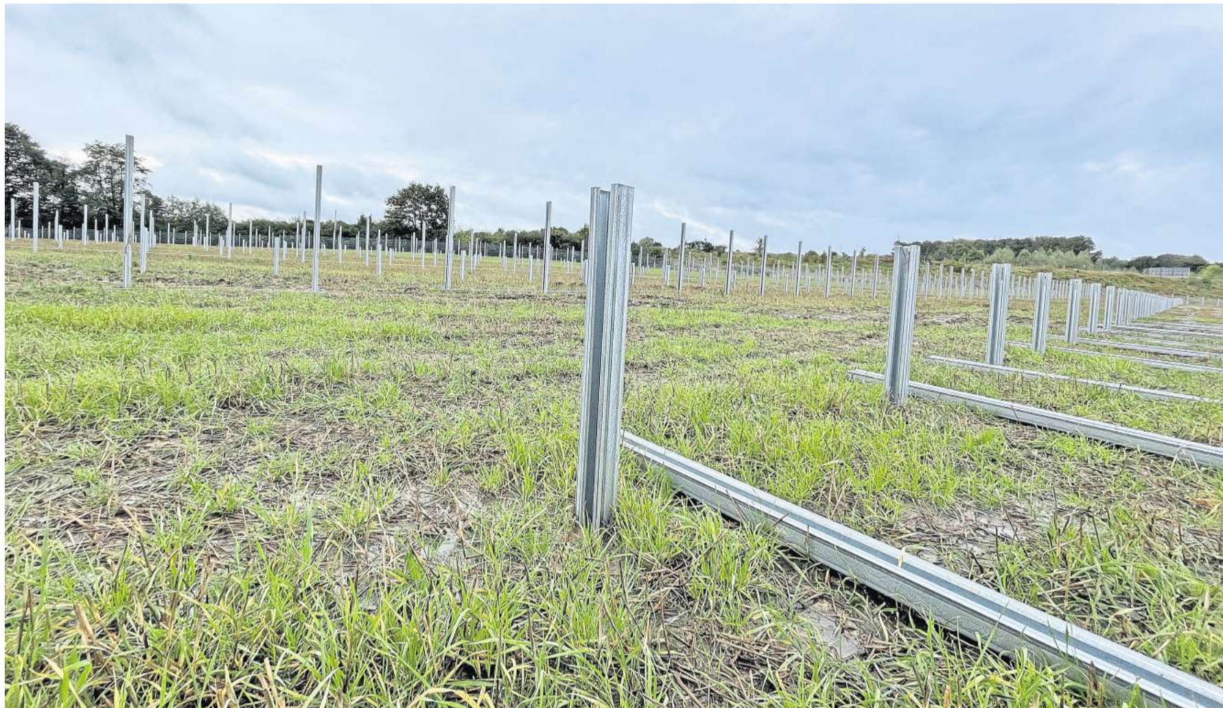
Neben der A20 entsteht der erste Teil des Solarparks Badendorf. 16.008 Solarmodule werden auf dem sieben Hektar großen Feld installiert. Die Unterkonstruktionen dafür stehen zum Teil bereits.
