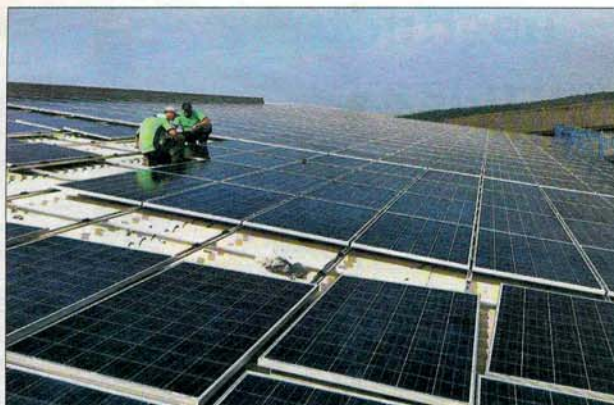
Die Aufdach-Solaranlagen in Süplingen haben eine installierte Gesamtleistung von 928 kW p .
