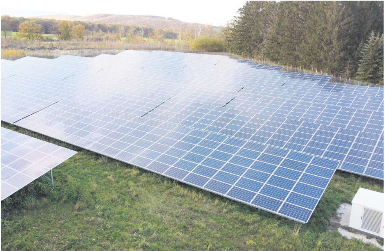
Die Vorbereitungen für die Erweiterung des Solarparks auf dem Gelände des früheren Kaliwerks „Hermann II“ nahe der Ortschaft Königsdahlum laufen auf Hochtouren.
