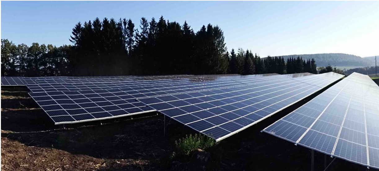
Blick auf den Solarpark in Königsdahlum in Bockenem auf dem ehemaligen Kaliwerk Hermann II (Foto: PIN Privates Institut für Energieversorgung GmbH)
